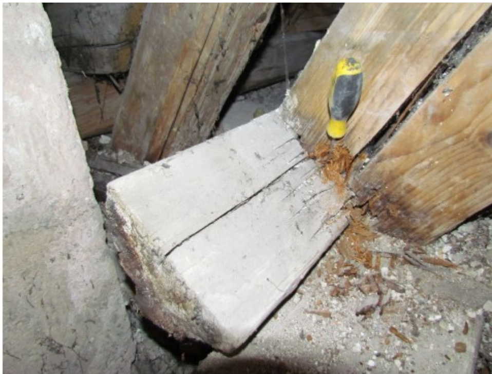
Geschädigte Binderstrebe sowie Fünfkantschwelle
